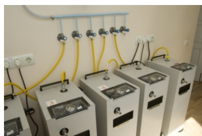
Фото: компресорна станція
